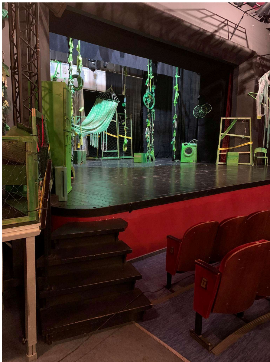
Zdj.5 Wejście na scenę jest niedostosowane dla osób poruszających się na wózkach
